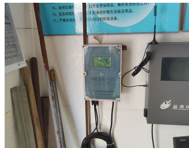
北城医院升级污水排出管理措施，对污水流量实现在线监测
